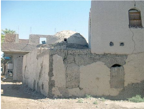
شكل (٢-٢٩) أحد المباني المتضررة
